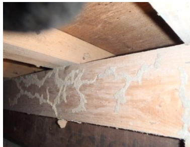
↑耐震診断時に床下で 蟻道発見
